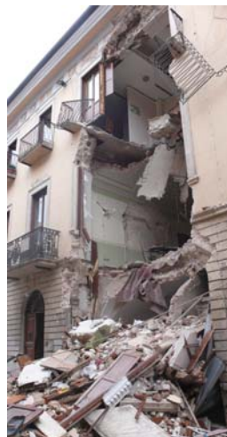
Foto: Arch. Fot. Vice Comm. Del. Beni Culturali - Sisma Abruzzo 2009
